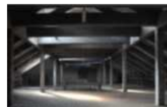
旧広島陸軍被服支廠の内部（3F） （鉄筋コンクリートでモダン）
