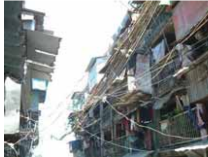
ファサードの鳥かご 通りに向けて片廊下が走るが、その廊下は1m近くセルフレッドによってせり出している。香港の九龍城でも同様の形態が見られ、鳥かごと呼ばれた。
