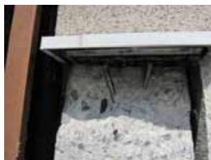
基礎が爆裂した状況
