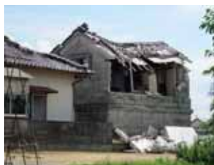
屋根が落ちた状況
