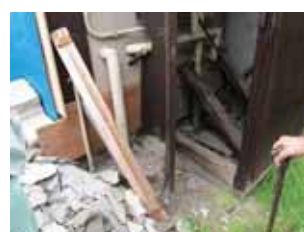
風呂の壁が落ちて中が見える状況
