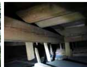
梁が割れてきた状況
